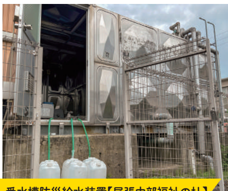
受水槽防災給水装置【尾張中部福祉の杜】
